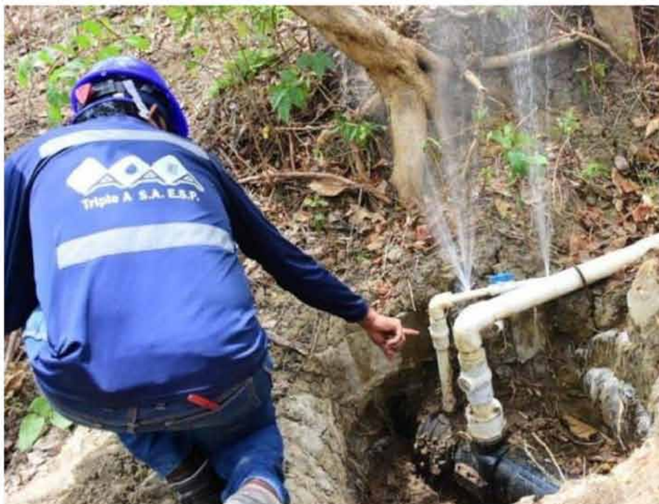
Un total de 170 conexiones fraudulentas han sido detectadas en el acueducto costero.
