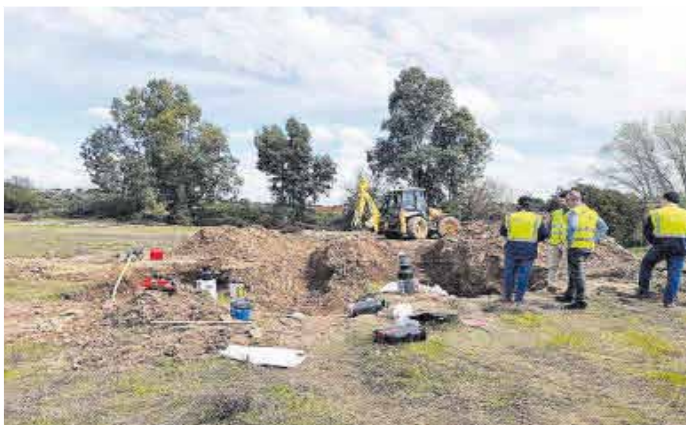
Restablecimiento del suministro.
