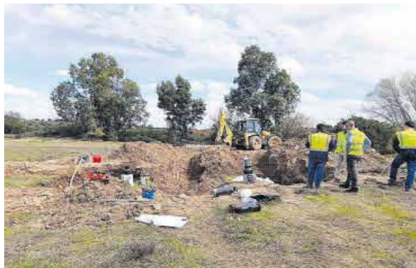
Restablecimiento del suministro.
