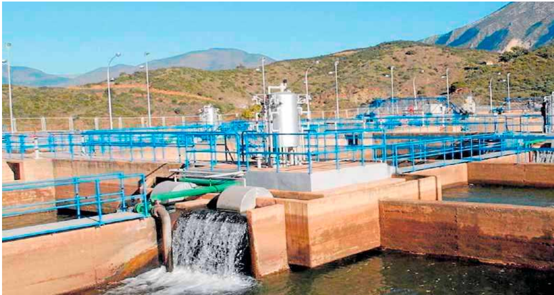
Instalaciones actuales de la potabilizadora del Verde. JOSELE
