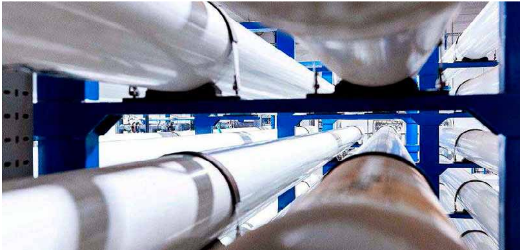
La Estación de Tratamiento de Agua Potable (ETAP) de Toledo cuenta con un nuevo sistema de desinfección del agua basado en dióxido de cloro. / LA TRIBUNA
